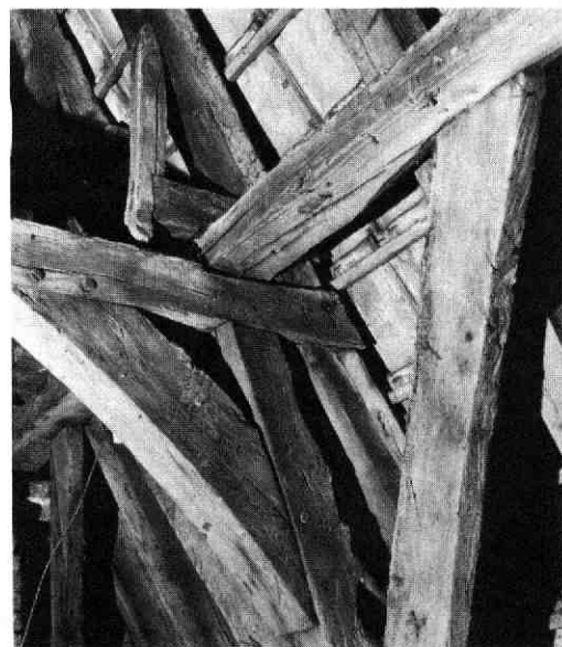
Afb. 226 Oude Gracht 307, Leeuwenberch. Detail van de verbinding tussen spoor en spant, bij spant 22.
