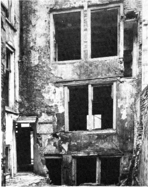
Afb. 241 Springweg 4 en 6. Achtergevel nr 4, eind 1968. Foto H. N. Bol. De zeer smalle ruimte van de hangplee is een halve steen in de zijgevel uitgehakt. De nog aanwezige bovendorpel van het opkamer-venster geeft aan dat dit oorspronkelijk naar links breder was. De kelderkeuken heeft een deur en een bolkozijn. Links is de in nr 4 uitgespaarde doorgang naar nr 6 te zien, waarboven de aansluiting van beide panden.
