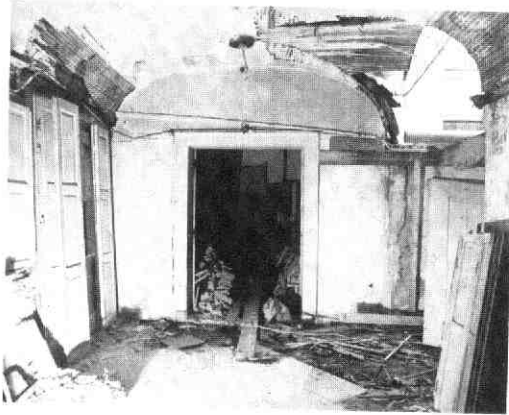
Afb. 22 Achter St Pieter 4. De dwarsvleugel gezien in de richting van de keuken. Links: de tuinzijde. Rechts: de hoofdgang met ingestort gewelf.
