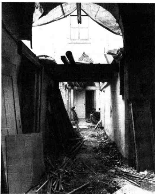
Afb. 26 Achter St Pieter 4. De hoofdgang gezien vanuit de dwarsvleugel na de instorting van het gewelf.
