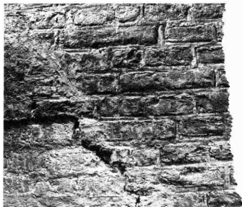
Afb. 82 Mariaplaats 9. Detail van het metsel-werk van de noordmuur (vroegere buitenzijde). On- links: een fragment van de verhoging van bouwfa- se 2. Het overige muurwerk (bouw-fase 3) vertoont een verschil in afwerking ter weerszijden van de dakmo- rand van de vroegere kap van Mariaplaats 10.
