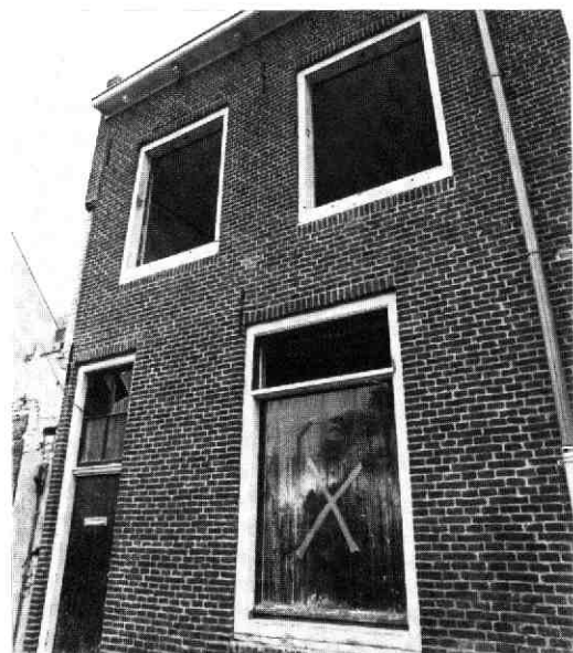
Afb. 188 Zilverstraat 44. Voorgevel. In de kozijnen van de verdieping zijn de pengaten zichtbaar van de verdwenen middendorpel en middenstijl.
