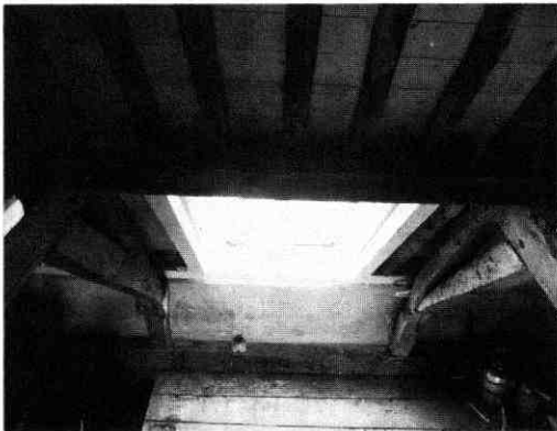
Afb. 161 Springweg 100. Detail van de kap. De spanten worden aan de westzijde gedragen door een balk langs de borstwering.
