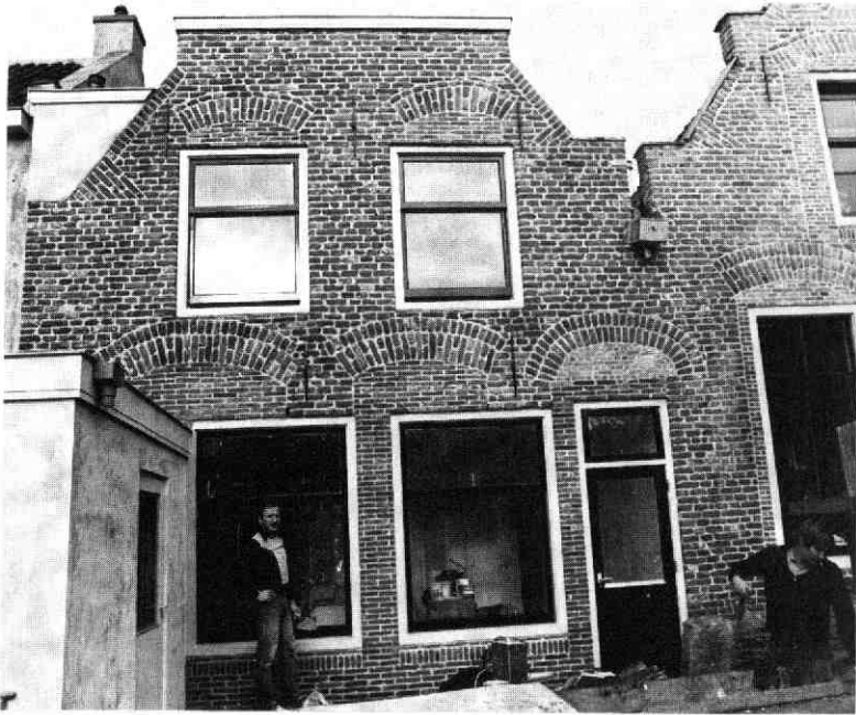
Afb. 185 Zilverstraat 36-38. Achtergevels. Vooral als gevolg van de 19e eeuwse verbouwing was de achtergevel zó slecht geworden, dat hij herbouwd moest worden. Daarbij is een deel van de top gereconstrueerd. De metselaar is terecht trots op het resultaat van zijn werk.
