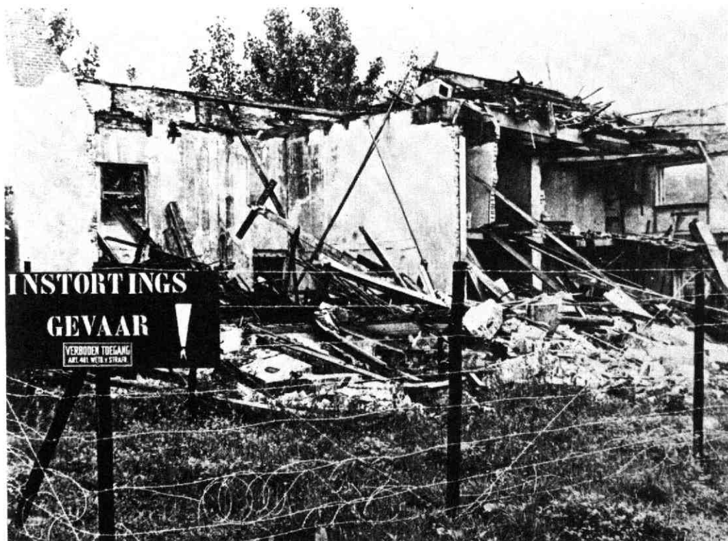
De bouwval Endelhoven (Utrechts Nieuwsblad d.d. 29 juni 1977; foto C. A. Otten)
