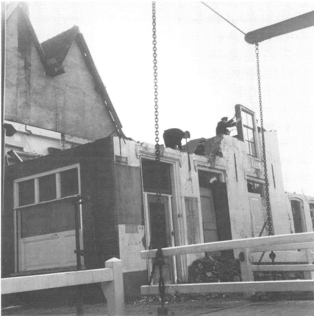
Afb. 6. De afbraak van het voorste deel van Het Keyserrijck in 1965. De gemeentewerklieden zijn: R. Hoogeveen, ?, W. Brouwer, G.J. Ruizendaal en P. Goris (foto mej. A.F. de Bruin).
