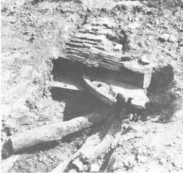
Fundering van de toren van de Oosteindermolen - vellingstuk en plooiestuk van een tandwiel. (foto P.C. Beunder)
